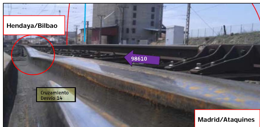
Vista del defecto de nivelación en altura en la zona anterior al punto "0".
